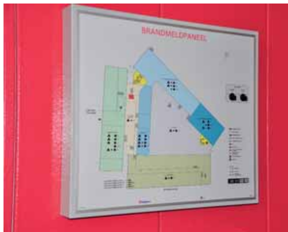
Houd bij de brandmeldinstallatie een logboek bij.
